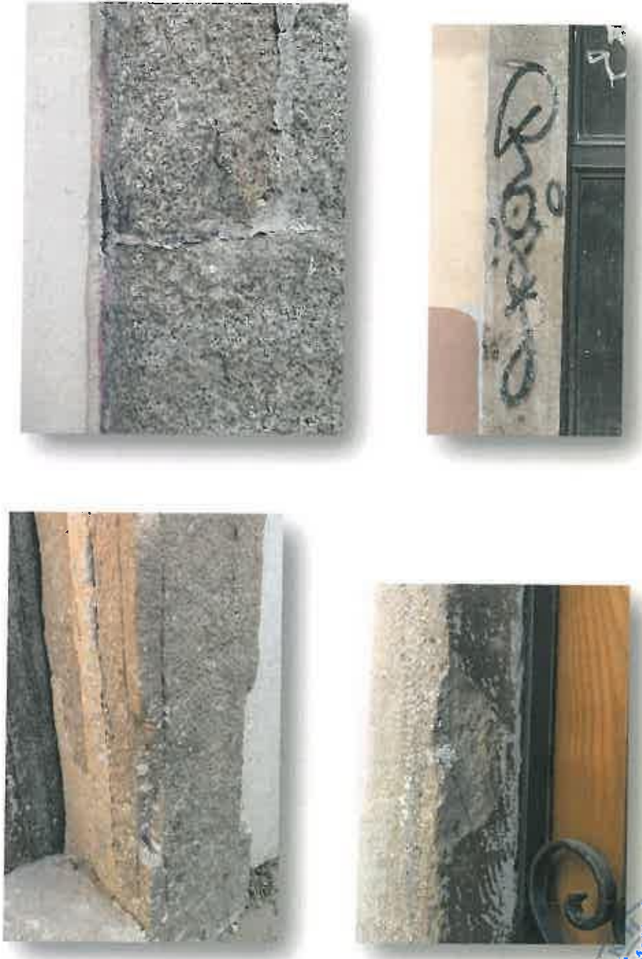
Εικόνες 101-104. Γράφιτι, χρωματισμοί, θραύσεις και απώλειες
