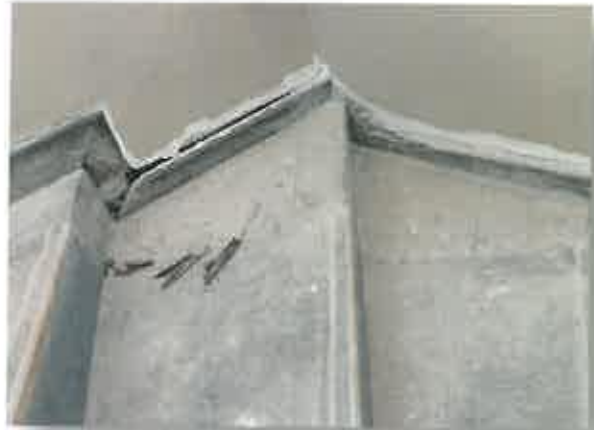
Εικόνα 16. Απώλεια στο σοβατεπί.
