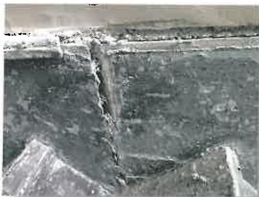
Εικόνα 47. Απώλεια ξύλινου πτήχη, καθώς και του ενδιάμεσου υλικού πλήρωσης.
