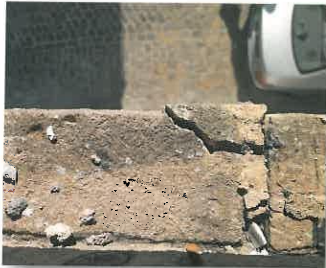
Εικόνα 108. Ετοιμορροπία τμημάτων στο γείσο της όψης
