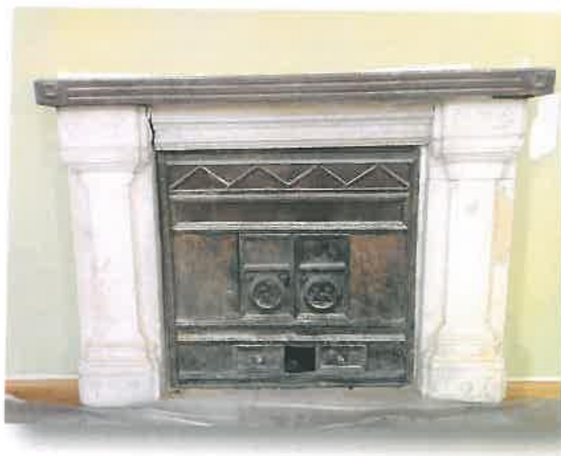
Εικόνα 118. Η μαρμάρινη εστία θέρμανσης
